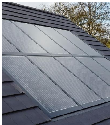
Indaks pv panelen
