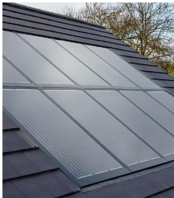
Indaks pv panelen
