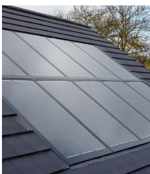
Indaks pv panelen
